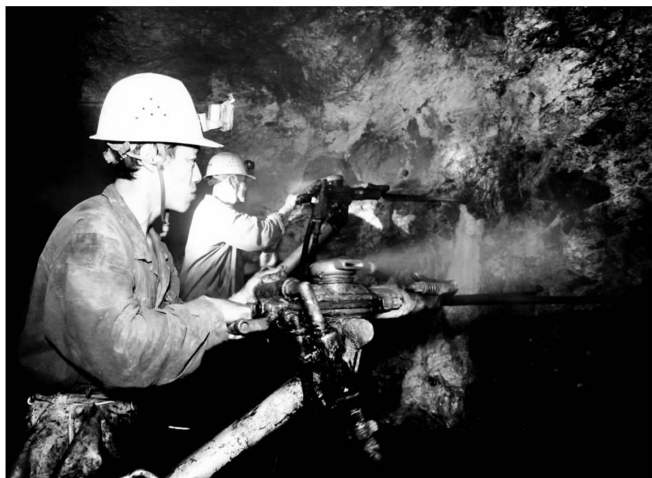
▲ 图为井巷公司铜山口项目部施工人员正在采矿作业。 郭小勇 摄
